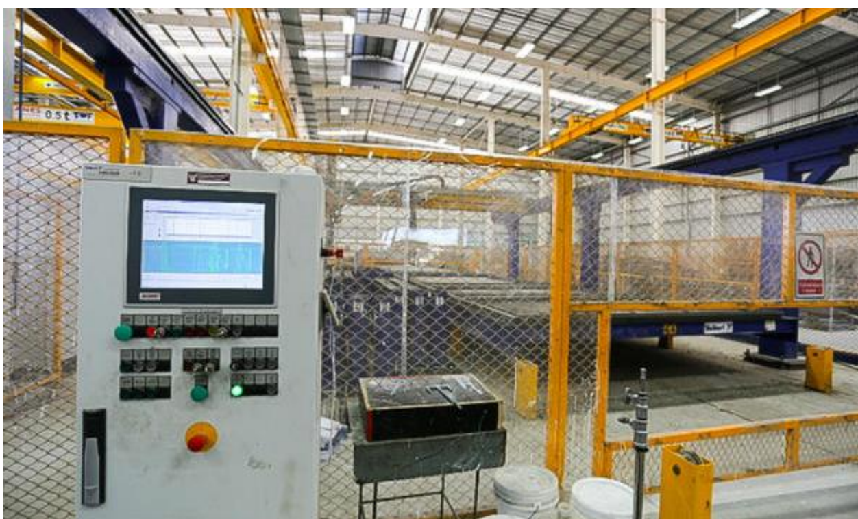
Рисунок 2. Пульт управления и зона работы автоматизированной линии по производству стеновых панелей (за ограждением) [7]
